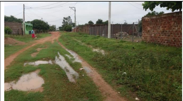
Foto 3.131. Vía interna del Barrio El Cruce destapada en malas condiciones Fuente: Ecoforest S.A.S., 2015.
