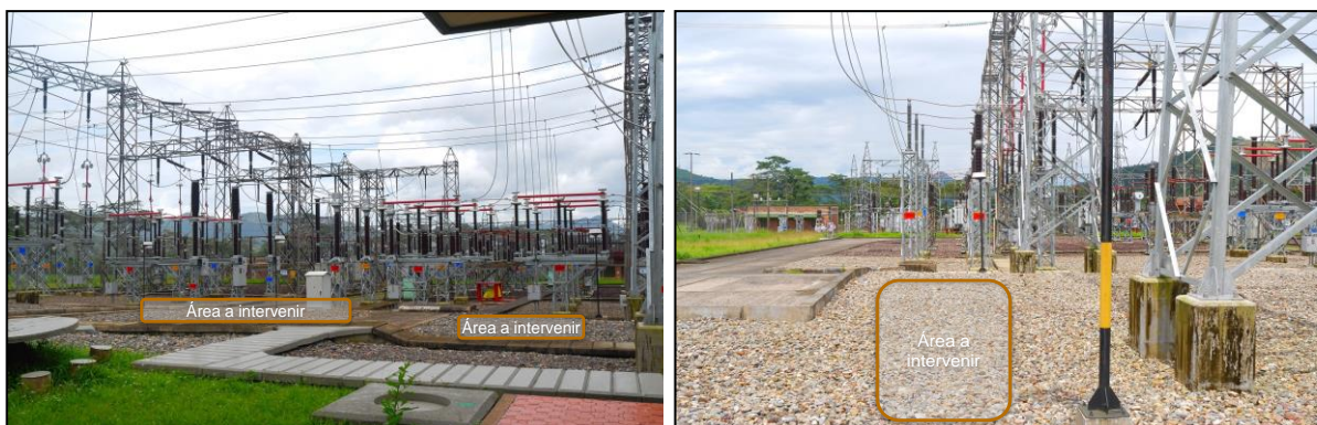
Fotografía 2-1 Ubicación de la bahía para las adecuaciones en la subestación La Reforma 230kV.
