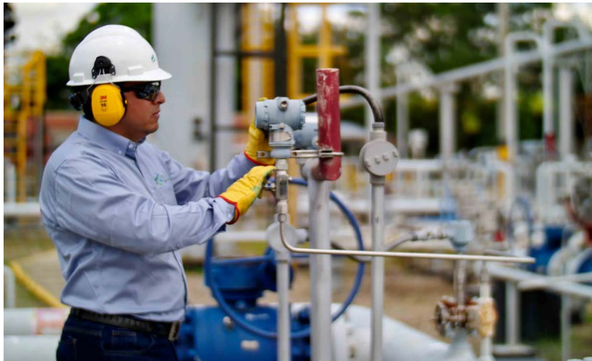
Colaborador de TGI en la Estación de compresión de gas Mariquita, Tolima
