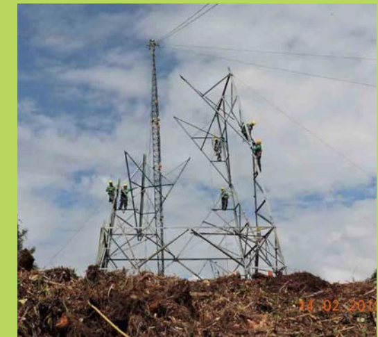
Jornada de construcción de la torre 309, segundo tramo proyecto Tesalia - Alférez en Pradera, Valle del Cauca
