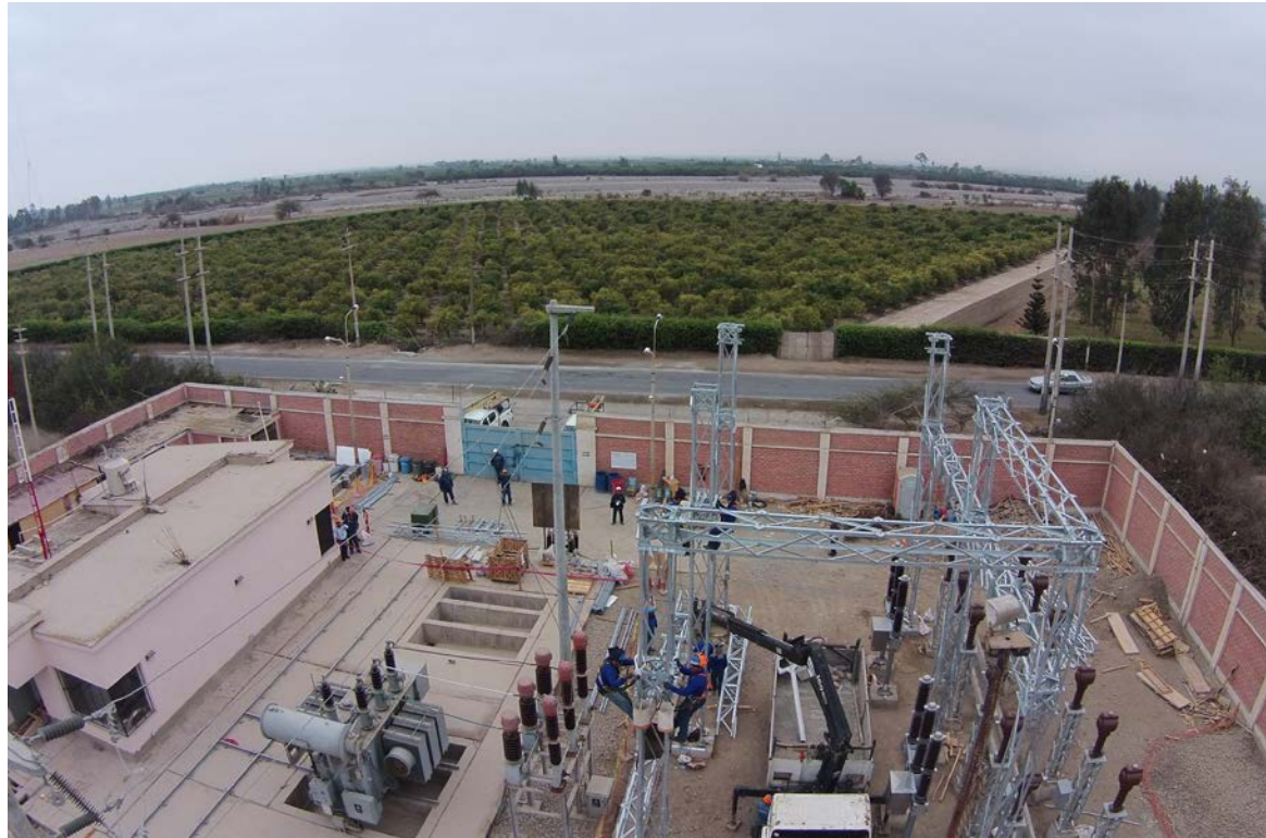
Infraestructura de Electro Dunas en Perú
