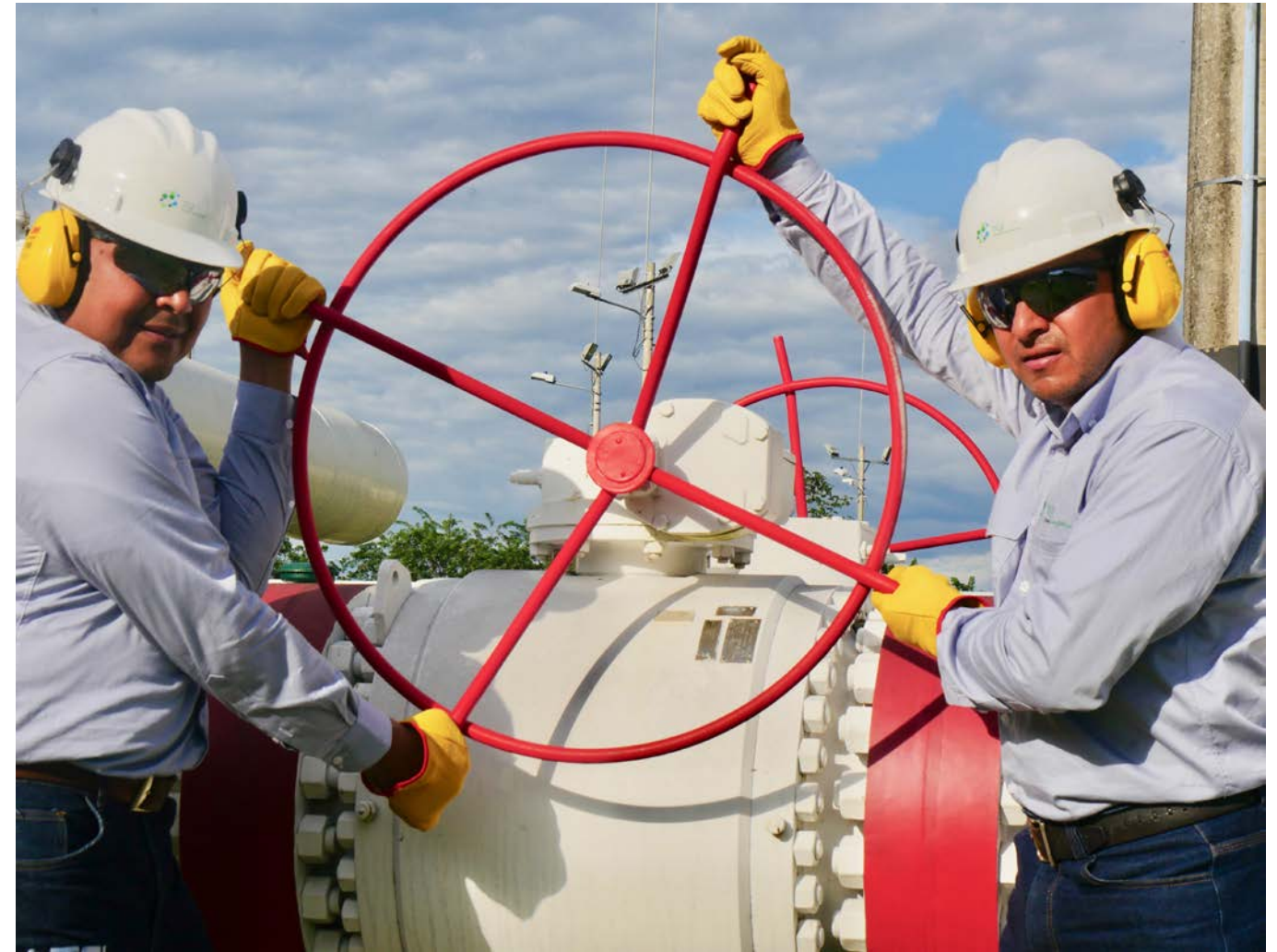
Colaboradores de TGI en la estación de compresión de gas en Mariquita (Tolima)
