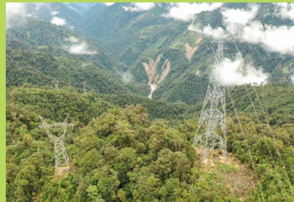
Después de arduas jornadas se levantó la torre que permite que al sur del país le llegue el servicio de energía eléctrica
