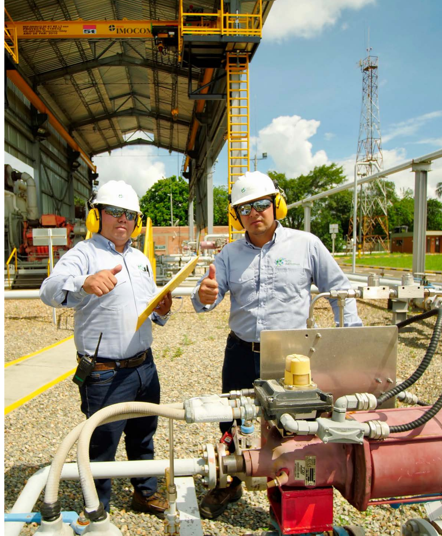
Colaboradores de TGI en la estación de compresión de Mariquita (Tolima)
