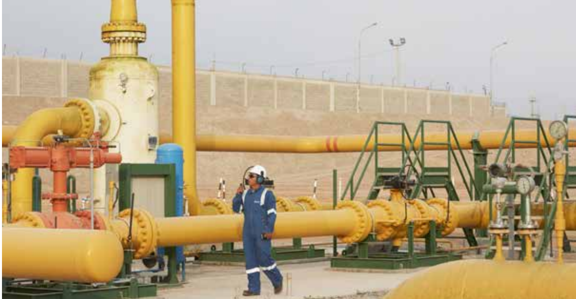
infraestructura Cálidda en Perú.
