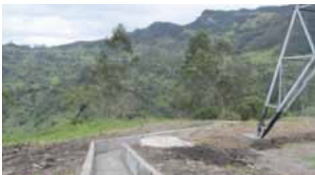
Foto 101. Obras para control de erosión torre 80, línea Guavio, circos I y II
