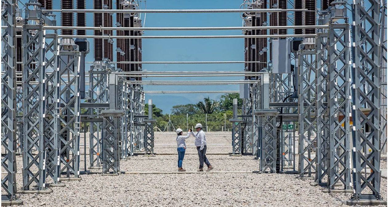
Subestación La Loma en Cesar
