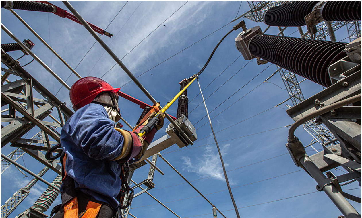
Colaborador en labor de mantenimiento, subestación Termocandelaria
