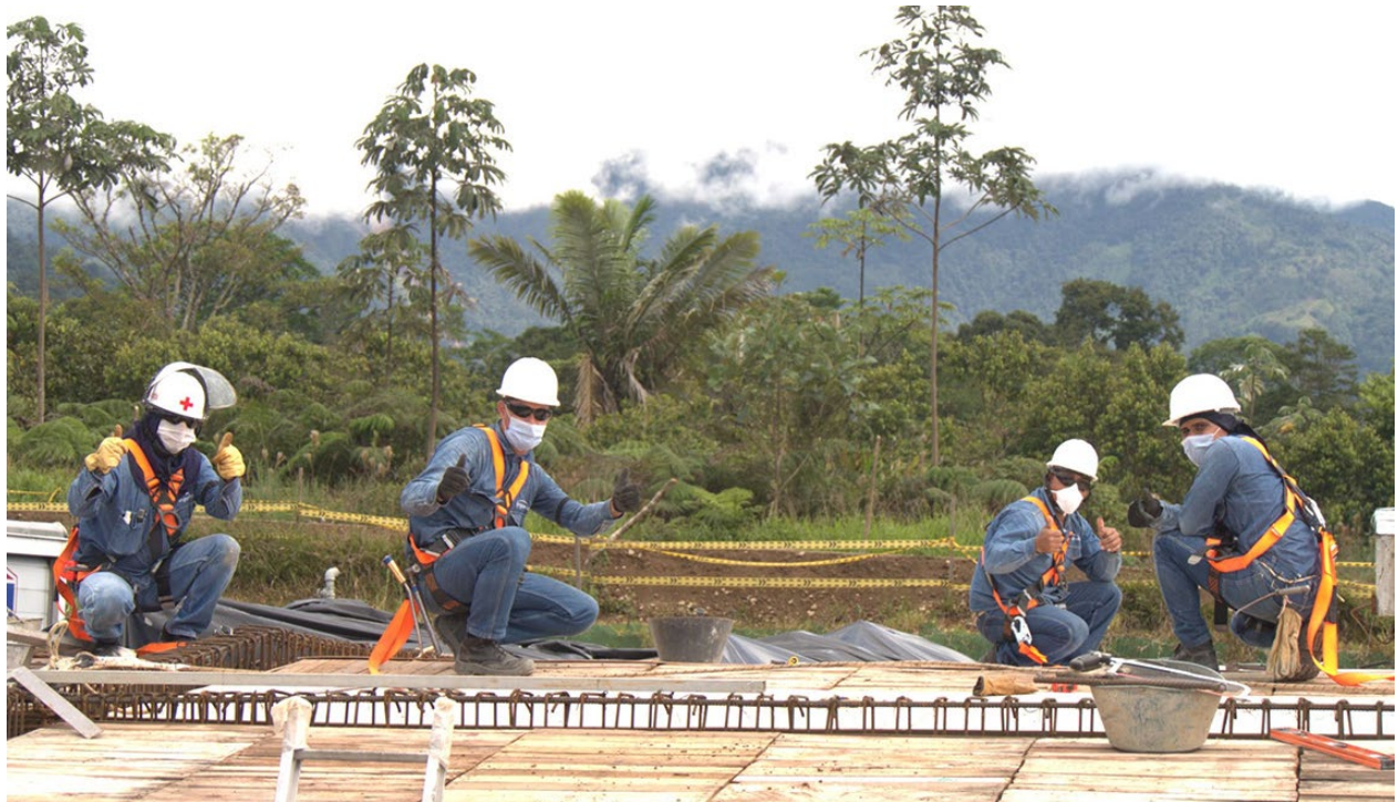
Contratistas de GEB en construcción y adecuación de la nueva subestación Renacer en Mocoa
