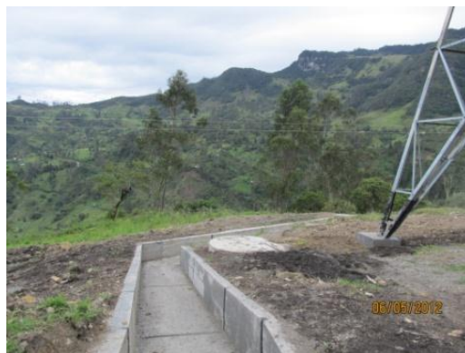
Foto 101. Obras para control de erosión torre 80, línea Guavio, circo I y II
